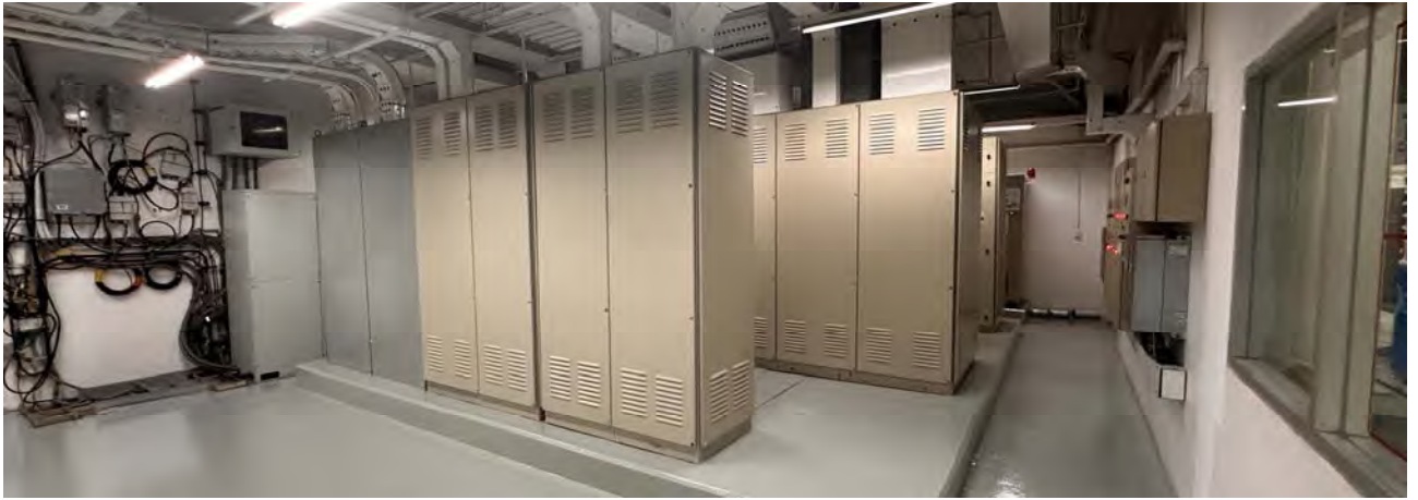
สภาพงานระบบไฟฟ้า
