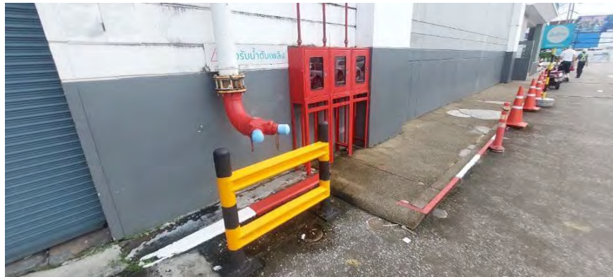
สภาพทั่วไประบบดับเพลิงภายในอาคาร
