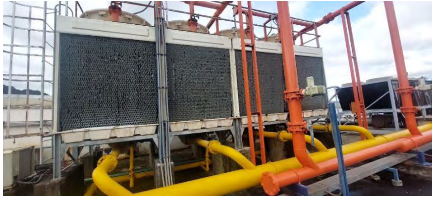
สภาพทั่วไปงานระบบอาคาร ทอระบายน้ำเย็น (Cooling Tower)
