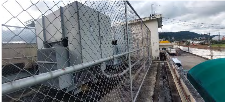
สภาพทั่วไปงานระบบอาคาร หม้อแปลงไฟฟ้า 1500 KV และ 2000 KV
