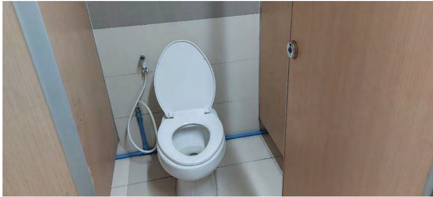
สภาพทั่วไปภายในสิ่งปลูกสร้างรายการที่ 1 / บริเวณส่วนพื้นที่สำนักงาน (Office Area) / ห้องน้ำพนักงาน ชั้นลอย
