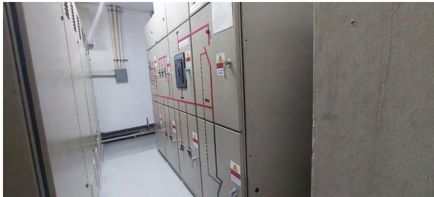
สภาพทั่วไปพื้นที่งานระบบอาคารห้องจ่ายกระแสไฟฟ้า (MDB Room)
