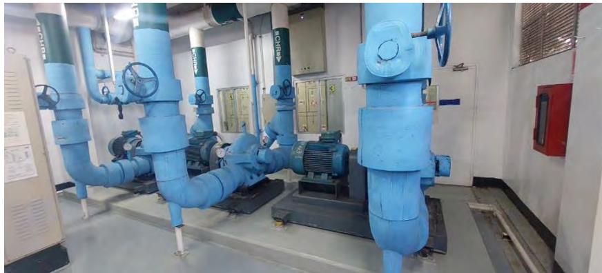
สภาพทั่วไปพื้นที่งานระบบอาคารห้องเครื่องสูบน้ำ (Pump Room)
