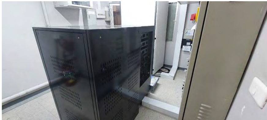
สภาพทั่วไปพื้นที่งานระบบอาคารห้องควบคุมระบบคอมพิวเตอร์ (Server Room)
