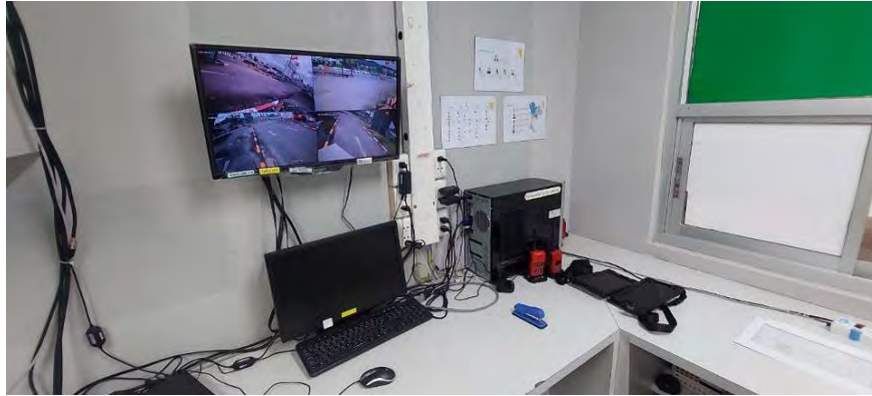
สภาพทั่วไปพื้นที่งานระบบอาคารห้อง CCTV
