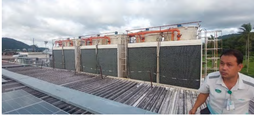
สภาพทั่วไปงานระบบอาคาร หอระบายน้ำเย็น (Cooling Tower)
