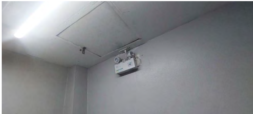
สภาพทั่วไปงานระบบไฟฟ้าสองสว่างฉุกเฉิน
