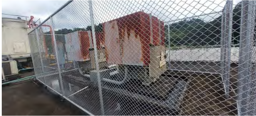
สภาพทั่วไปงานระบบอาคาร หม้อแปลงไฟฟ้า 1000 KV
