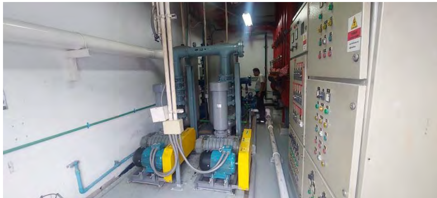
สภาพทั่วไปพื้นที่งานระบบอาคารห้องปั้มน้ำระบบดับเพลิง (Water Pump-Fire Pump)
