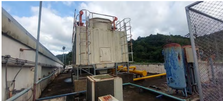
สภาพทั่วไปงานระบบอาคาร หอระบายน้ำเย็น (Cooling Tower)
