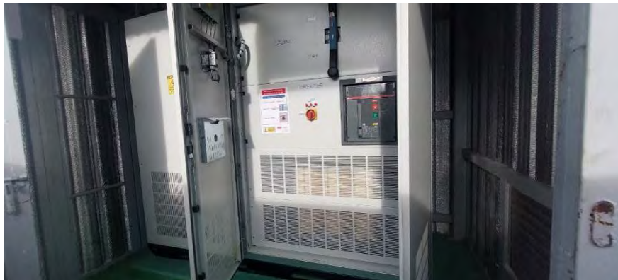
สภาพทั่วไปงานระบบอาคาร ห้องไฟฟ้า (AVR)
