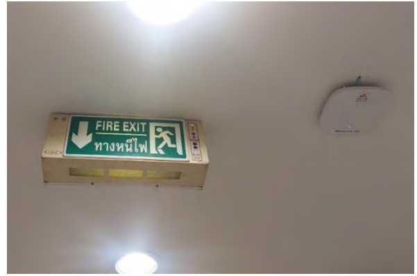
สภาพทั่วไประบบดับเพลิงภายในอาคาร
