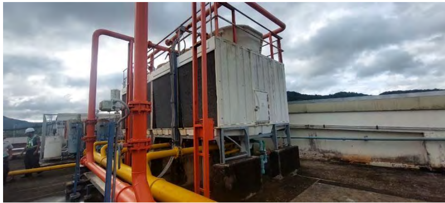
สภาพทั่วไปงานระบบอาคาร ทอระบายน้ำเย็น (Cooling Tower)
