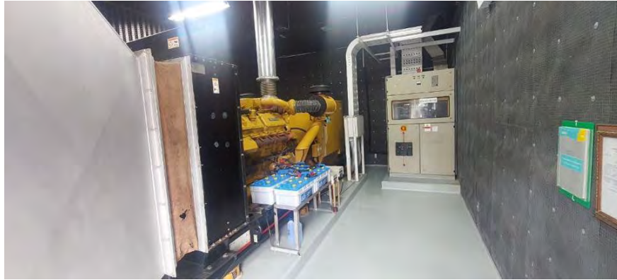
ภาพทั่วไปพื้นที่งานระบบอาคารห้องเครื่องกำเนิดไฟฟ้า (Generator Room)
