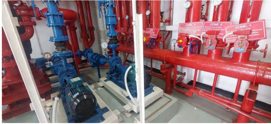
สภาพทั่วไปพื้นที่งานระบบอาคารห้องปั้มน้ำระบบดับเพลิง (Water Pump-Fire Pump)
