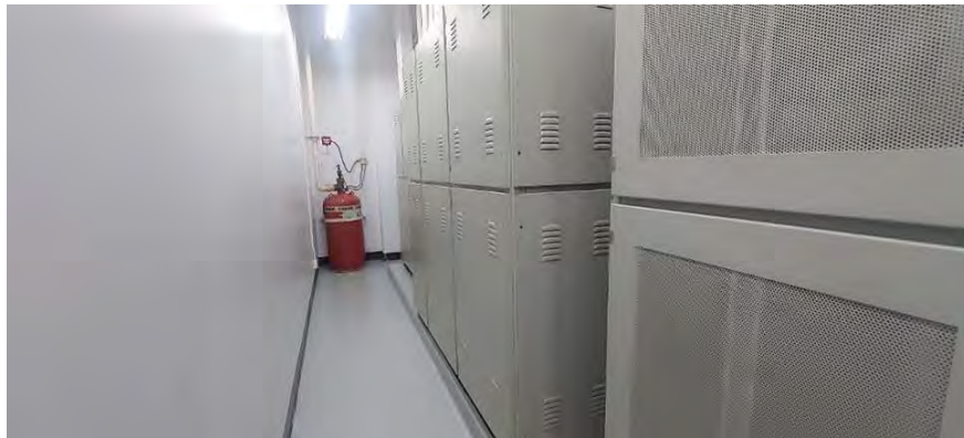
สภาพทั่วไปพื้นที่งานระบบอาคารห้องจ่ายกระแสไฟฟ้า (MDB Room)
