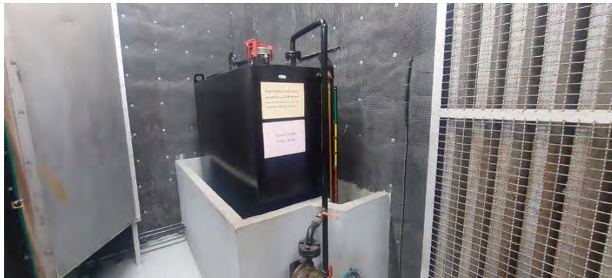
ภาพทั่วไปพื้นที่งานระบบอาคารห้องเครื่องกำเนิดไฟฟ้า (Generator Room)
