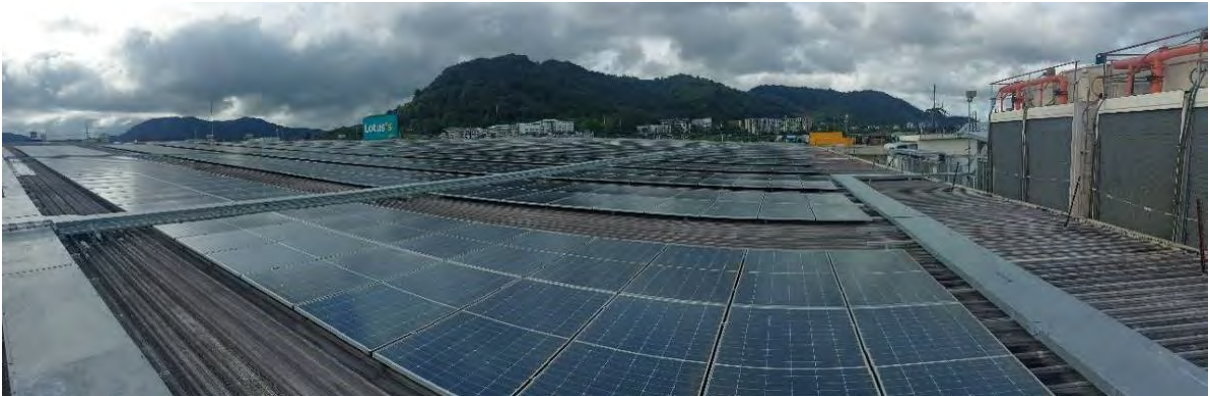
สภาพทั่วไปงานระบบอาคาร ระบบโซลาร์เซลล์ (Solar Cell)
