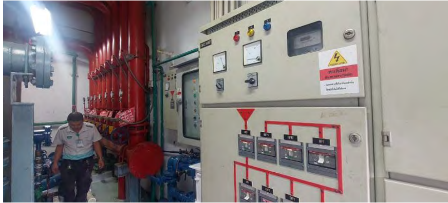
สภาพทั่วไปพื้นที่งานระบบอาคารห้องปั้มน้ำระบบดับเพลิง (Water Pump-Fire Pump)
