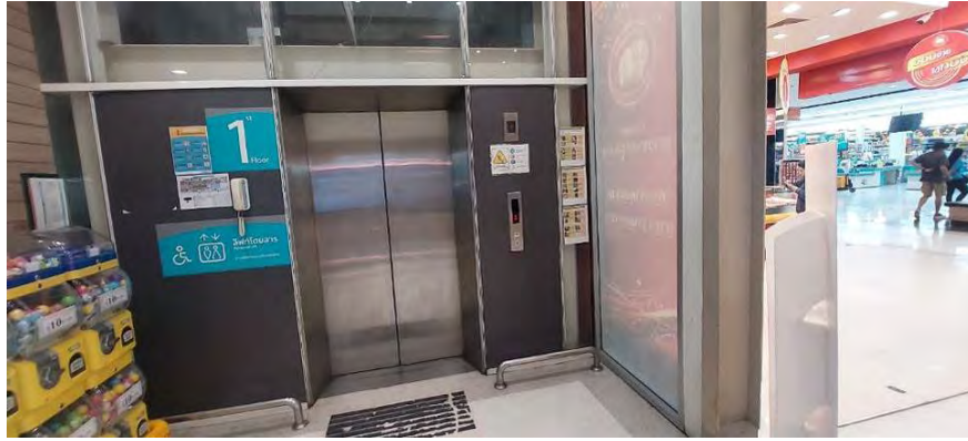
สภาพทั่วไปลิฟต์โดยสารภายในอาคาร
