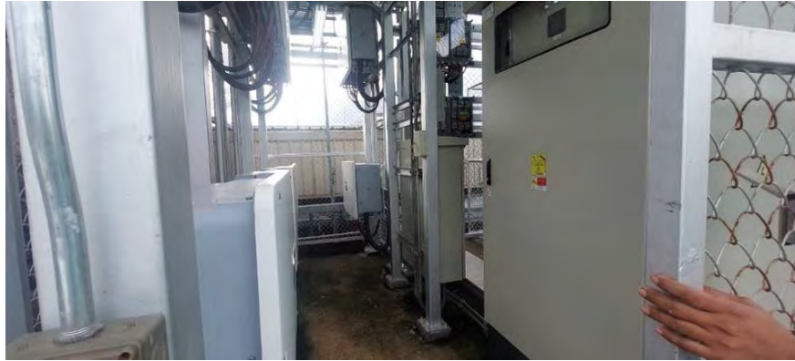
สภาพทั่วไปงานระบบอาคาร ระบบโซล่าเซลล์ (Solar Cell)
