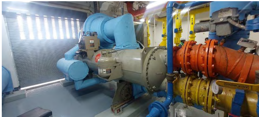
สภาพทั่วไปพื้นที่งานระบบอาคารห้องเครื่องสูบน้ำ (Pump Room)
