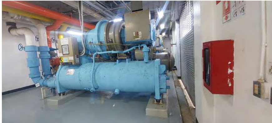
สภาพทั่วไปพื้นที่งานระบบอาคารห้องเครื่องสูบน้ำ (Pump Room)
