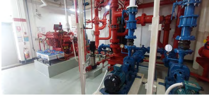
สภาพทั่วไปพื้นที่งานระบบอาคารห้องปั้มน้ำระบบดับเพลิง (Water Pump-Fire Pump)
