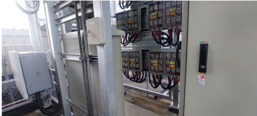
สภาพทั่วไปงานระบบอาคาร ระบบโซล่าเซลล์ (Solar Cell)
