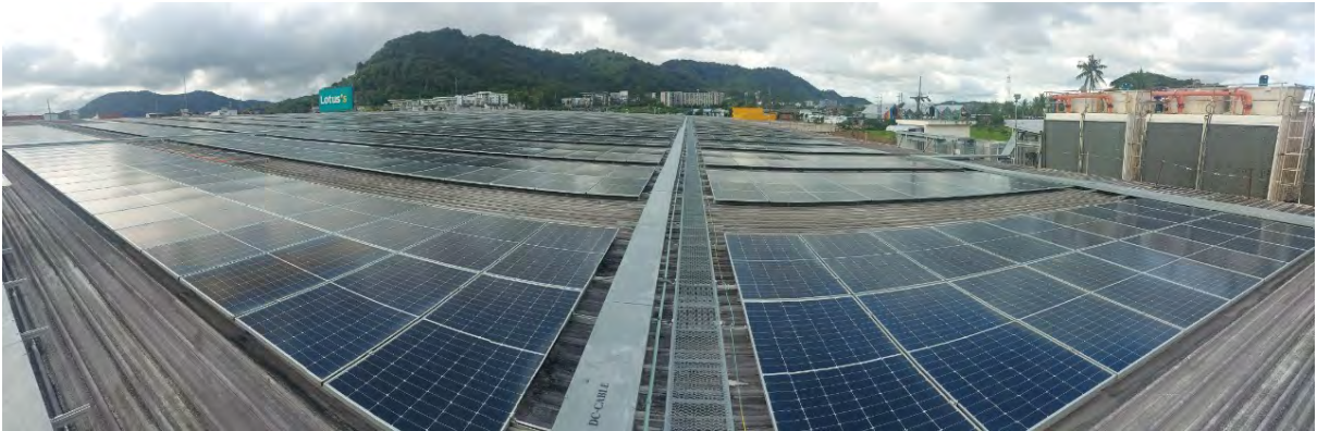
สภาพทั่วไปงานระบบอาคาร ระบบโซลาร์เซลล์ (Solar Cell)
