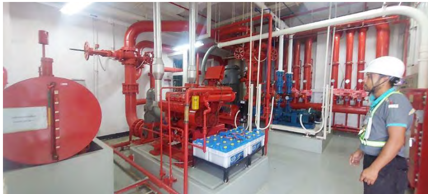
สภาพทั่วไปพื้นที่งานระบบอาคารห้องปั้มน้ำระบบดับเพลิง (Water Pump-Fire Pump)
