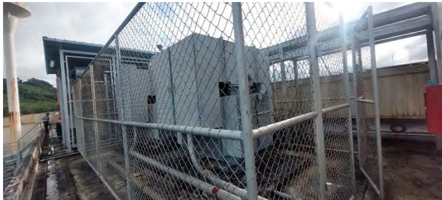
สภาพทั่วไปงานระบบอาคาร หม้อแปลงไฟฟ้า 1500 KV และ 2000 KV
