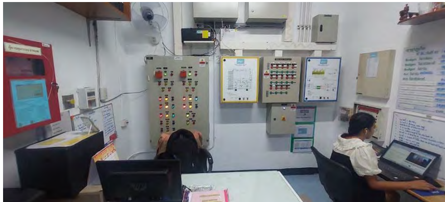
สภาพทั่วไปพื้นที่งานระบบอาคารห้องจ่ายกระแสไฟฟ้า (MDB Room)
