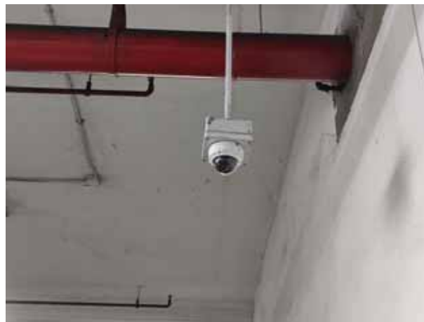
สภาพงานระบบ CCTV
