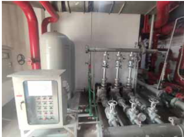
สภาพงานระบบประปา
