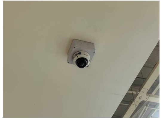
สภาพทั่วไปงานระบบ CCTV
