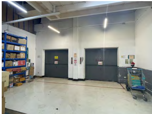
สภาพงานระบบภายในอาคาร-ลิฟต์ขนของ (Service Lift)
