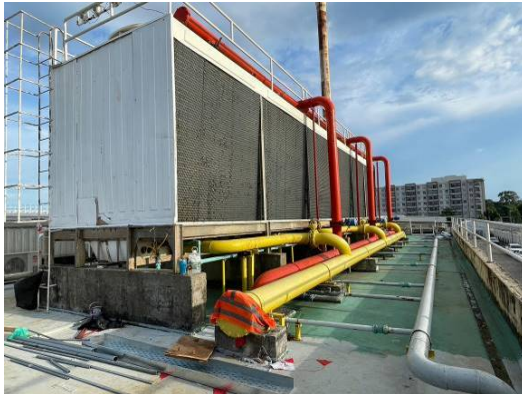
สภาพงานระบบภายในอาคาร-หอระบายน้ำความร้อน (Cooling Tower)
