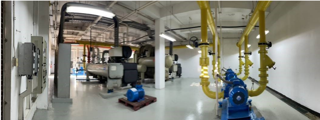
สภาพงานระบบภายในอาคาร-ห้องแอร์ซิลเลอร์ (Chiller Room)
