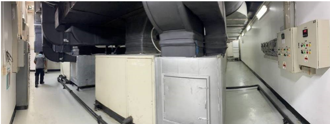
สภาพงานระบบภายในอาคาร-ห้องเครื่องเป่าลมเย็น 1 (A.H.U Room 1)
