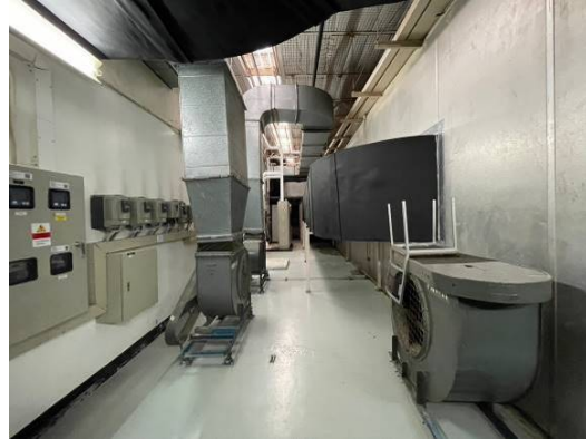
สภาพงานระบบภายในอาคาร-ห้องเครื่องเป่าลมเย็น 2 (A.H.U Room 2)
