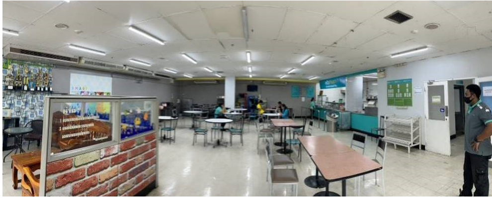
สภาพภายในอาคารฯ ชั้นลอย บริเวณพื้นที่สำนักงาน (Back Office)
