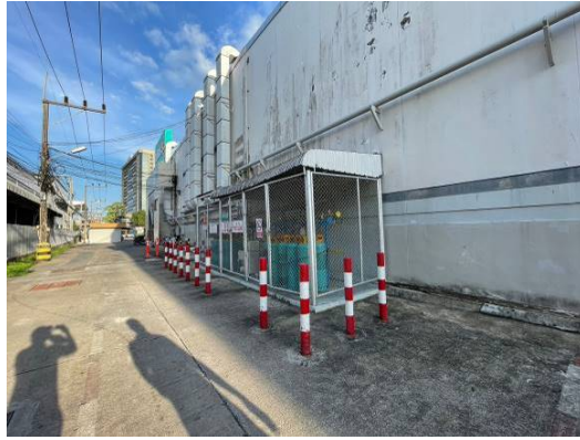
สภาพจากระบบภายนอกอาคาร-ห้องเก็บแก๊ส (Gas Station)
