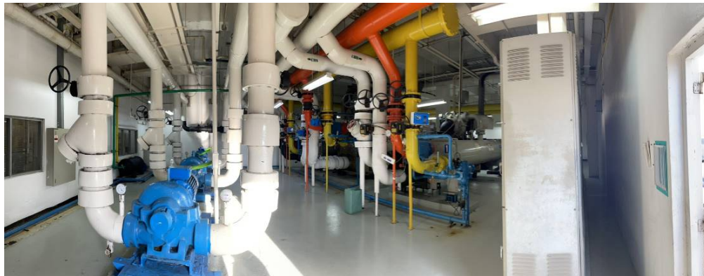
สภาพงานระบบภายในอาคาร-ห้องแอร์ชิลเลอร์ (Chiller Room)
