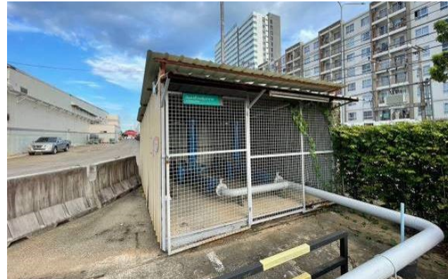
สภาพงานระบบภายนอกอาคาร-ห้องเครื่องเติมอากาศ (Aerator Room)
