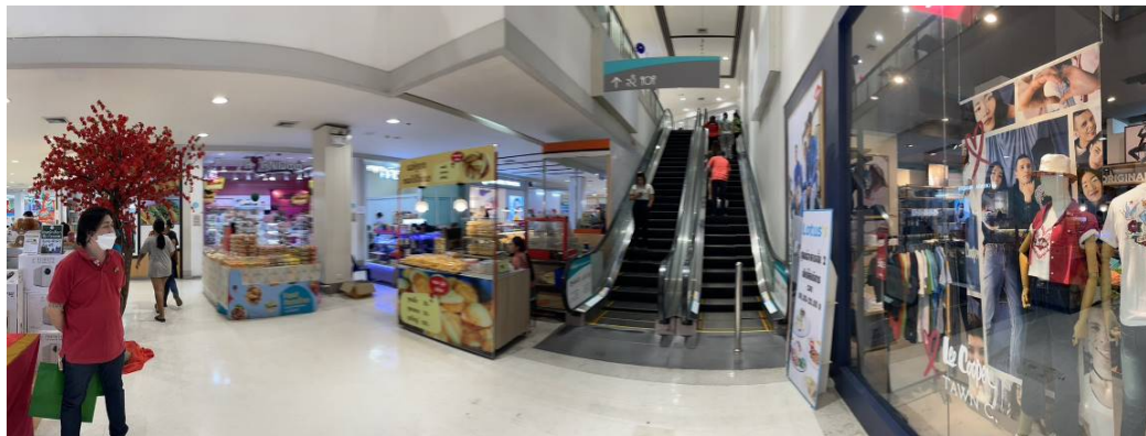
สภาพงานระบบภายในอาคาร-บันไดเลื่อน (Escalator)
