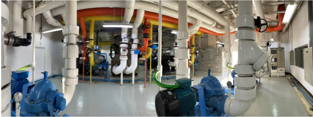
สภาพงานระบบภายในอาคาร-ห้องแอร์ซิลเลอร์ (Chiller Room)
