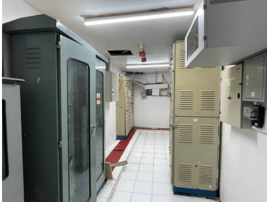
สภาพงานระบบภายในอาคาร-ห้องไฟฟ้า 2 (Electrical Room 2)
