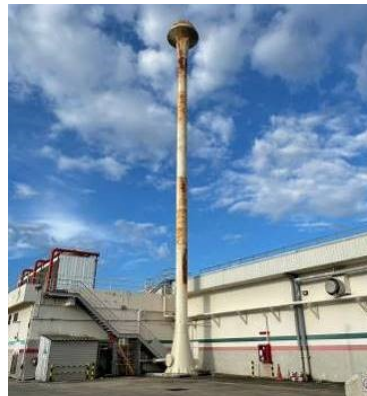
สภาพงานระบบภายนอกอาคาร-หอถังน้ำ (Water Tank Tower)
