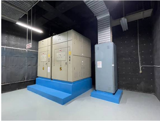
สภาพงานระบบภายในอาคาร-ห้องเครื่องกำเนิดไฟฟ้า (Generator Room)
