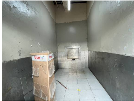
สภาพงานระบบภายในอาคาร-ห้องขยะแห้ง (Dry Garbage)
