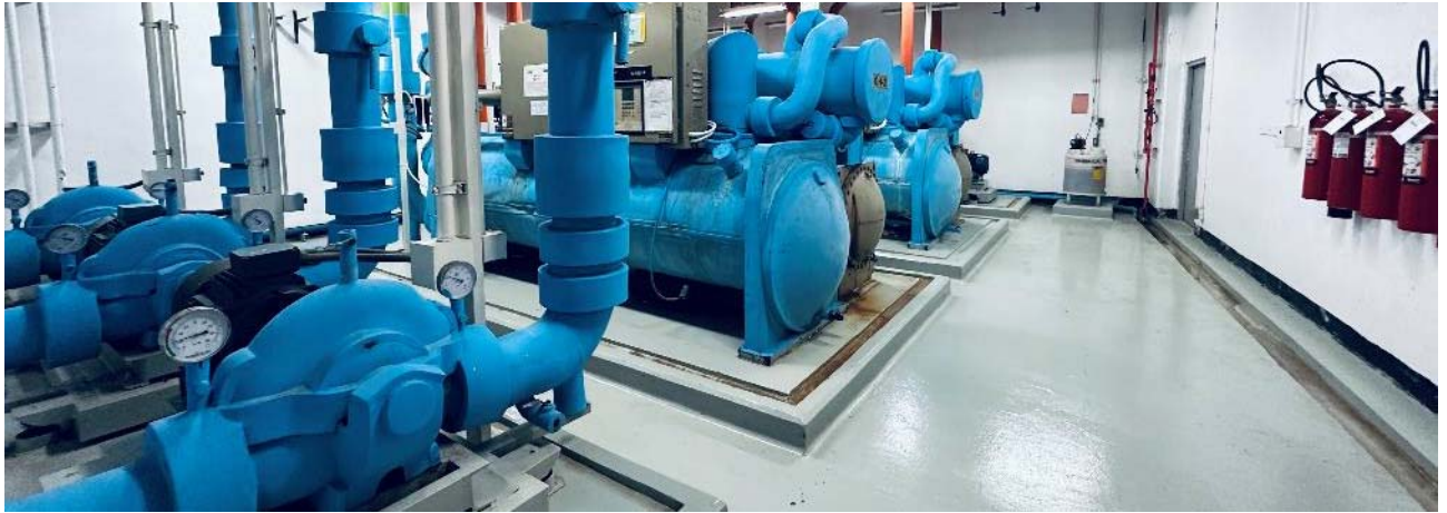
สภาพงานระบบปั้มน้ำ
