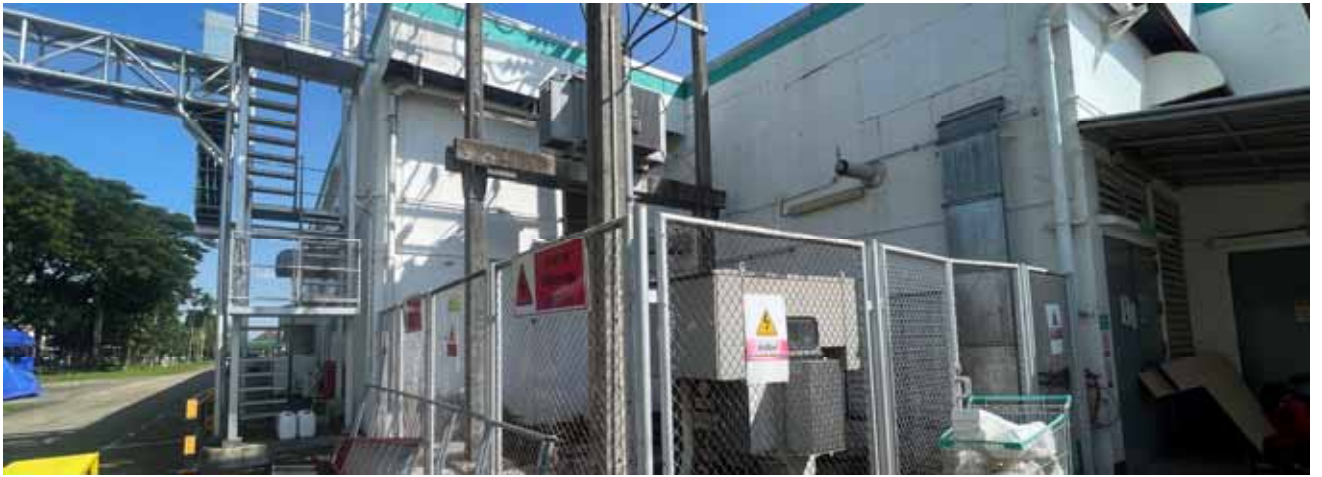
สภาพงานระบบไฟฟ้า (หม้อแปลงไฟฟ้า)
