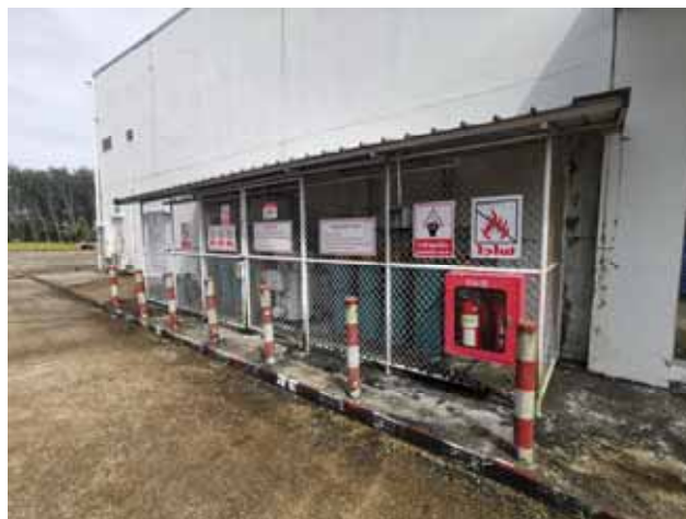
ระบบภายในอาคาร / ระบบก๊าซหุงต้ม
