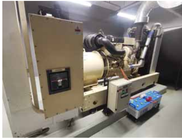
ระบบภายในอาคาร / ระบบไฟฟ้าสำรอง
