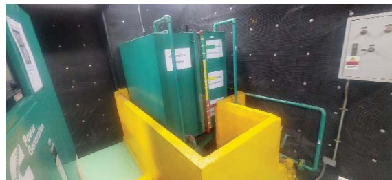
สภาพทั่วไปพื้นที่งานระบบอาคารห้องเครื่องกำเนิดไฟฟ้า (Generator Room)
