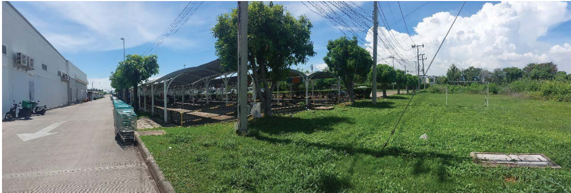
สภาพทั่วไปสิ่งปลูกสร้างรายการอื่นๆ / ส่วนหลังคาคลุม (จอดรถ)
