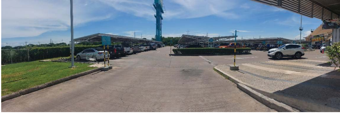
สภาพทั่วไปสิ่งปลูกสร้างรายการอื่นๆ / ส่วนหลังคาคลุม (จอดรถ)
