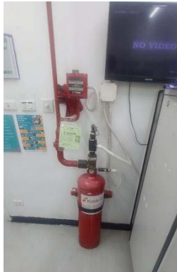
สภาพทั่วไประบบดับเพลิงภายในอาคาร
