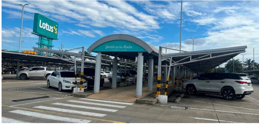
สภาพสิ่งปลูกสร้างอื่นๆ / ที่จอดรถหลังคาคลุม
