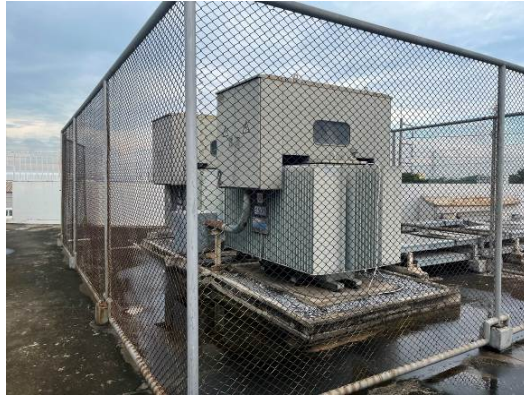
สภาพทั่วไปงานระบบประกอบอาคาร / ห้องแปลงไฟฟ้าแรงสูง
