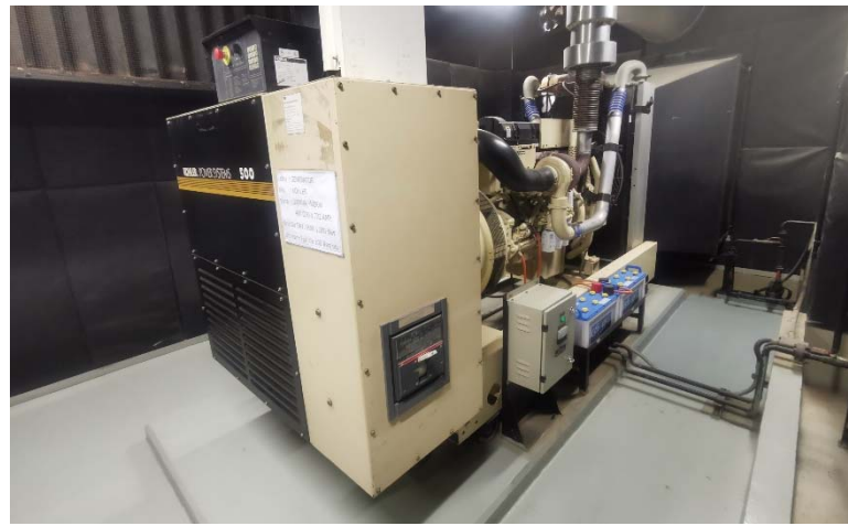
ระบบภายในอาคาร / ระบบไฟฟ้าสำรอง
