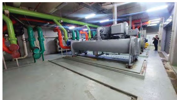
สภาพทั่วไปพื้นที่งานระบบควบคุมระบบความเย็น (Compressor Room)
