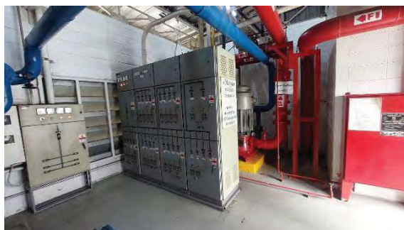
สภาพทั่วไปภายในห้องเครื่องสูบน้ำ
