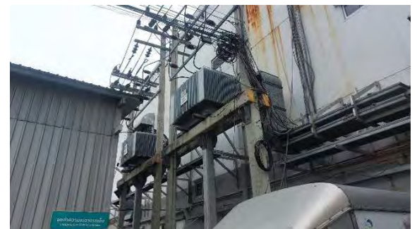
สภาพทั่วไปงานระบบอาคาร หม้อแปลงไฟฟ้า 1600 KV
