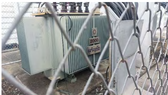
สภาพทั่วไปงานระบบอาคาร หม้อแปลงไฟฟ้า 2000 KV
