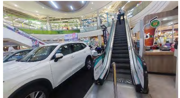
สภาพทั่วไประบบบันไดเลื่อน
