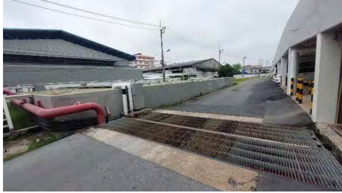
สภาพทั่วไปสิ่งปลูกสร้างรายการอื่นๆ / บ่อน้ำดีและบ่อน้ำเสีย
