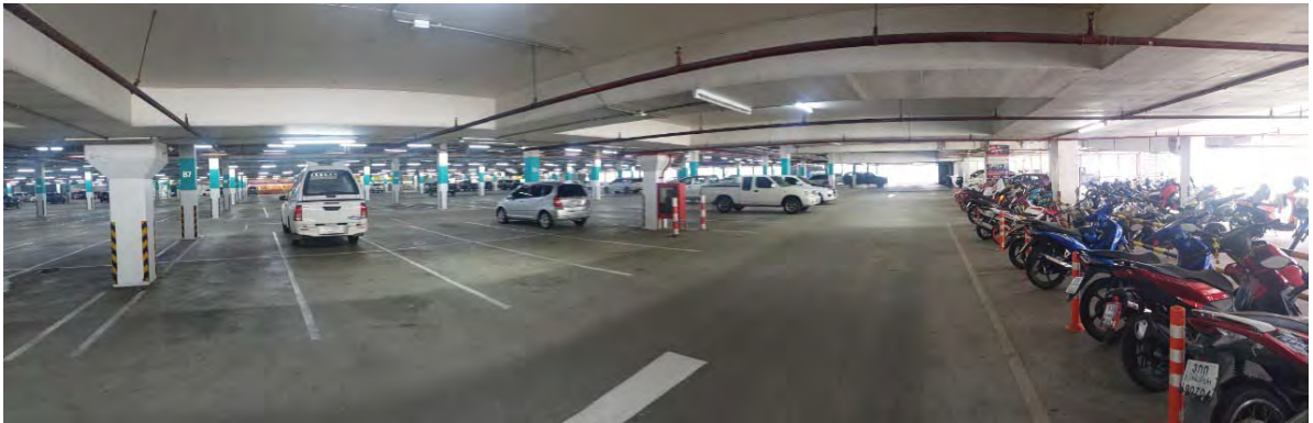
สภาพทั่วไปภายในสิ่งปลูกสร้างรายการที่ 1 / บริเวณส่วนพื้นที่จอดรถใต้อาคาร
