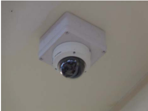
สภาพงานระบบวงจรปิด
