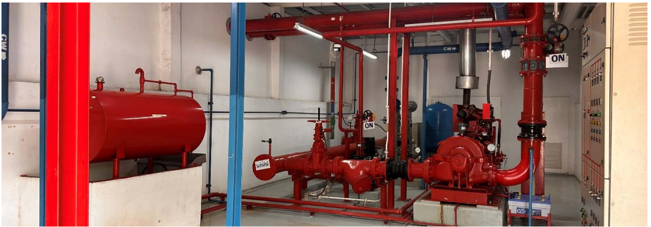
สภาพงานระบบป้องกันอัคคีภัย
