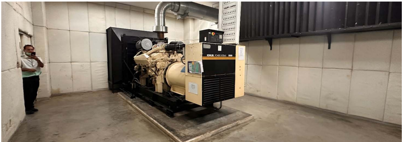
สภาพงานระบบไฟฟ้าสำรอง
