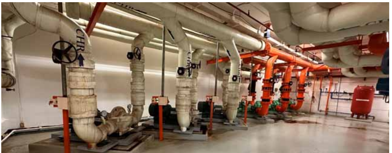
สภาพงานระบบปรับอากาศ
