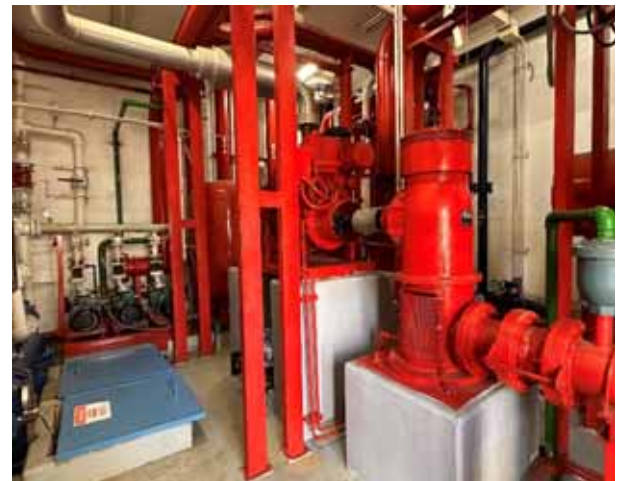
สภาพงานระบบป้องกันอัคคีภัย
