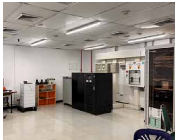
ห้องงานระบบไอที
