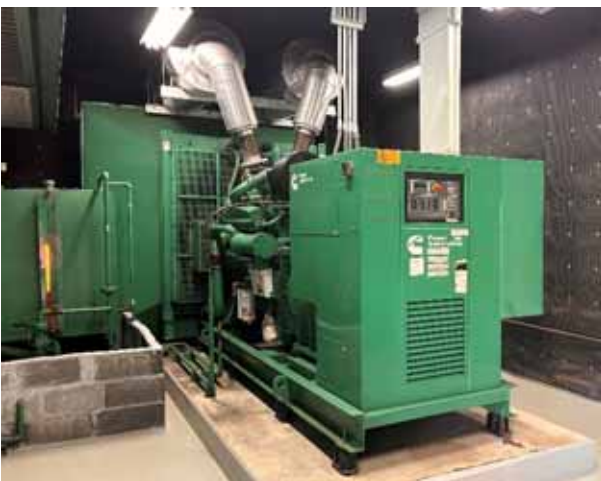
สภาพงานระบบไฟฟ้าสำรอง
