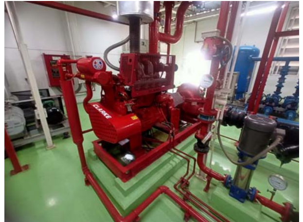
สภาพงานระบบป้องกันอัคคีภัย
